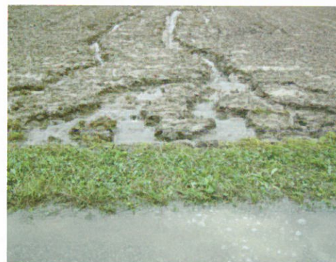
Erosionsrinnen durch Wasserzufluss von einer Strasse.
